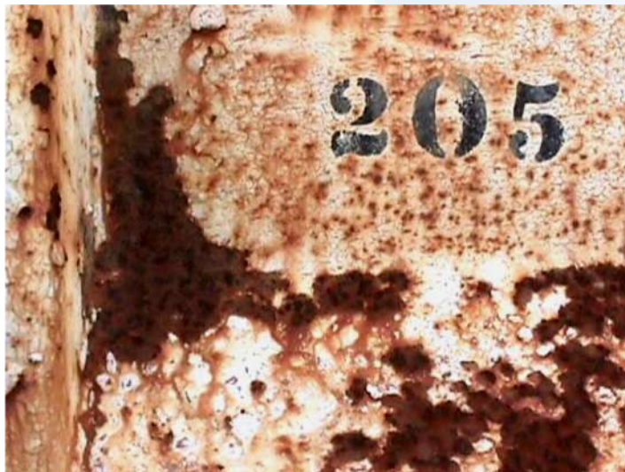
Nótese en la foto el ampollamiento que se produce en la pintura por formación de celdas de corrosión bajo el recubrimiento.
