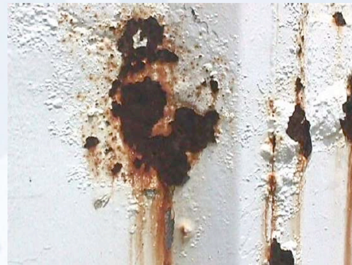
Nótese en la foto el ampollamiento que se produce en la pintura por formación de celdas de corrosión bajo el recubrimiento, debido a la migración de agua bajo el recubrimiento la cual forma HCL de baja concentración
