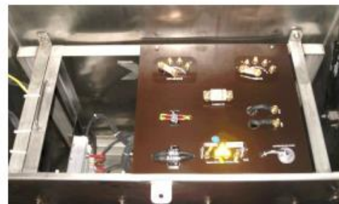
Vista superior rectificador refrigerado por aceite.
