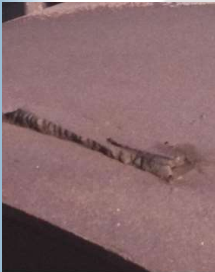
Anomalia: soporte cortado
