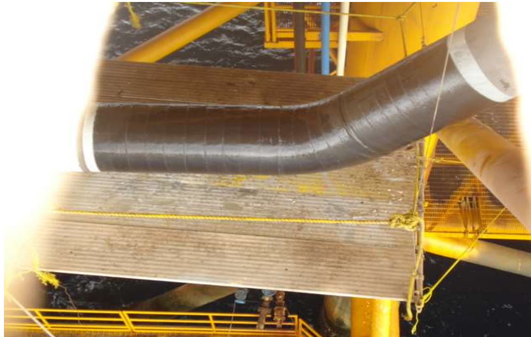
Plataforma de Pemex: Tubería de 24"Ø Abkatum/A
